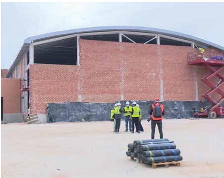
▲ Vista del estado avanzado de las obras de la nueva instalación deportiva.
